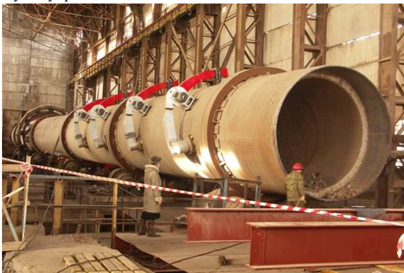
Вращающаяся печь в Иркутской области
