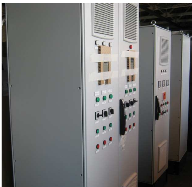
Рис. 4. Шкафы системы АСУ ТП
