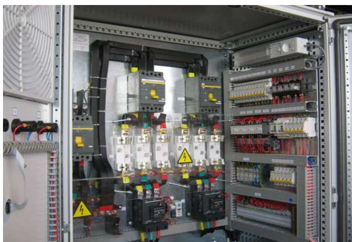
Рис. 10. Шкаф системы АСУ ТП
