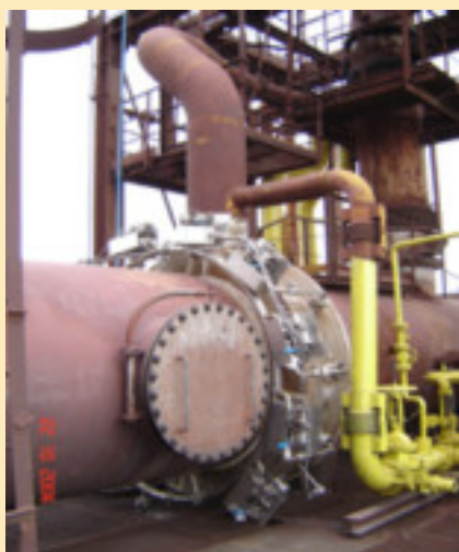
ОАО «ОЭМК». Установка металлизации №4
